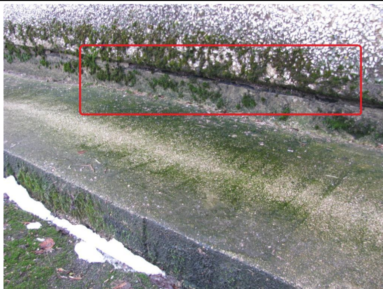
4.5.1.att. Šuve starp pamatiem un virszemes sienas paneļiem. Šuvju hermetizācijā un hidroizolācijā konstatēti ievērojami bojājumi. Siltumizolācija ēkā nav izmantota.
