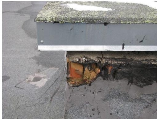
4.8.3.att. Virs jumta atrodas ventilācijas šahtu izvadi no mūrētiem ķieģeļiem, kas mitruma un sala ietekmē bojāti (izdrupuši, saplaisājuši). Virs šahtam jumtiņi, kas aizsargā šahtas no tiešu nokrišņu ūdeņu iekļūšanas.
