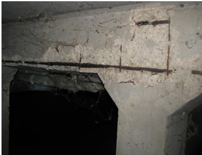
4.1.2. att. Pamatu elementiem atdalījusies betona aizsargkārtā. Stiegrojums korodējis.
