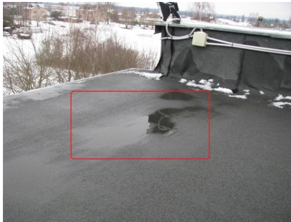
4.8.2.att. Jumta virsma nelīdzena; ar nepietiekošu kritumu. Vairākās vietās uz jumta krājas un nenotek nokrišņu ūdeņi. Lokāli bojājumi segumā: plaisas, nehermētiskas šuves.
