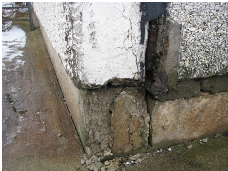
4.1.3.att. Šuvju atvērumi/spraugas starp saliekamajiem pamatu elementiem. Cokoldaļa mitra, lokāli mitruma un sala izraisīti bojājumi. Šuves starp saliekamajiem elementiem nehermētiskas. Bojāta/atdalījusies stiegrojuma betona aizsargkārtā un šuvju izolācijas aizsargkārtā.
