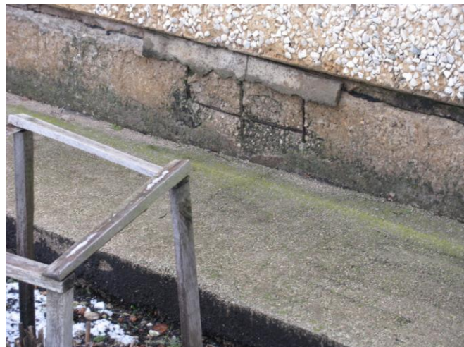
4.1.4.att. Ārpusē pamatu cokoldaļā bojāta stiegrojuma betona aizsargkārtā. Stiegrojums
