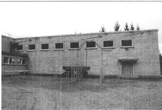
Jumta hidroizolacija ir mehaniski bojata uz sienas ir redzami mitruma plankumi.
